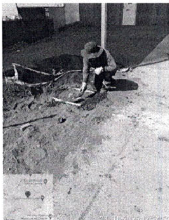
Base poste de iluminación camino concón-reñaca oriente
