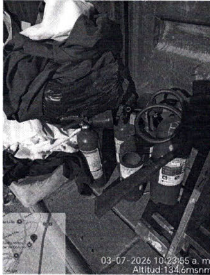
Extintores de CO2
