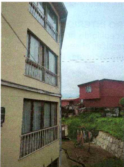
bajada de aguas lluvias
